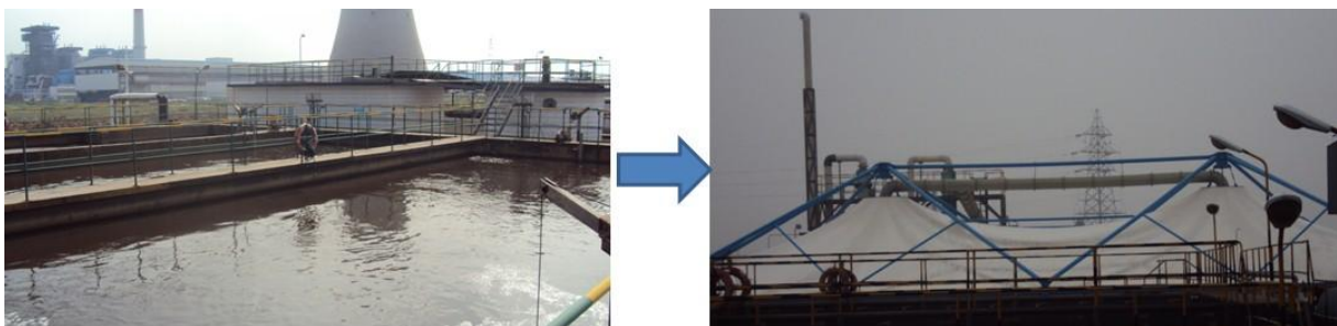
废水处理系统中厌氧池的改造
