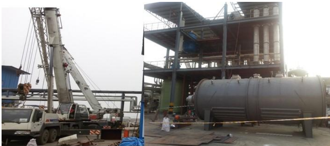
正在建设的高盐废水脱盐系统（台州联化）
