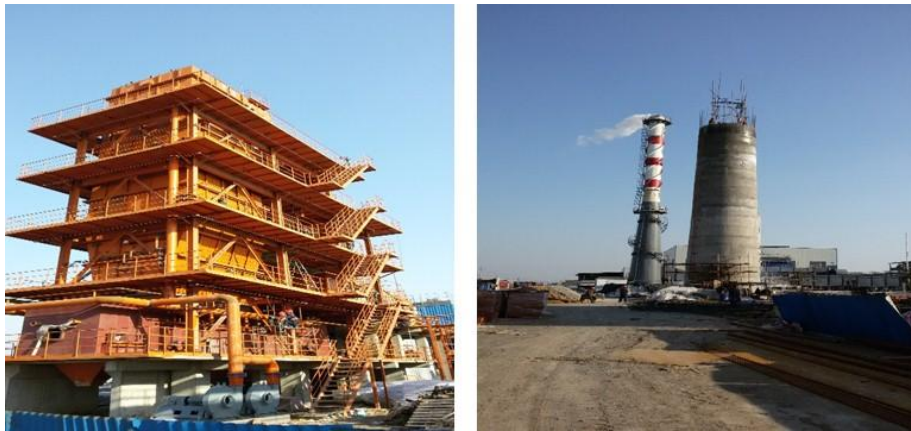
正在建设的三合一焚烧炉系统（盐城联化） 正常运行的三合一焚烧炉系统（江苏联化）
